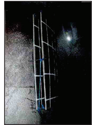
Eingebaute Katalysatorelemente zur Behandlung des Kreislaufwassers
